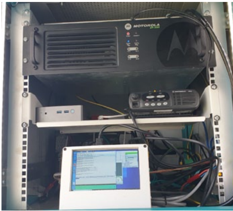
oben – Schrank 1: DMR Repeater, Mini-PC, Vara-FM Modem mit 2m Transceiver, Monitor für die Inbetriebnahme
