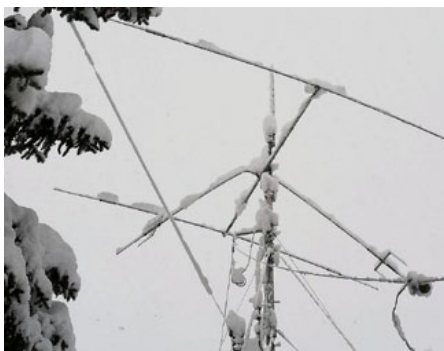
oben: die beschädigte Antenne von OE9WPV
