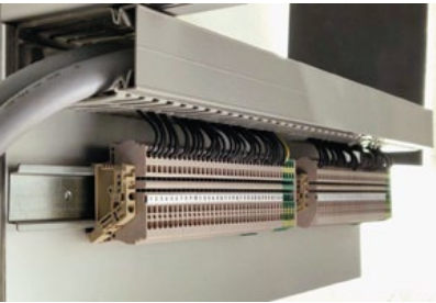
Steuerleitungen im Shack
