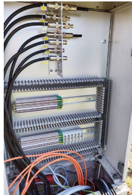
oben: die Verkabelung im Außenschrank
